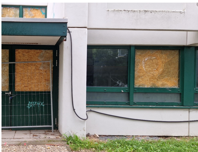
Improvisierte Kabelführung für die BMW-Werbung am HSH (oben) sowie für die Franziskaner-Werbung entlang der Balkone vom O-Haus (rechts).
